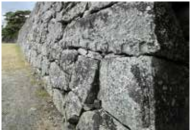
3054 箕輪門東側平場の石垣の損傷
