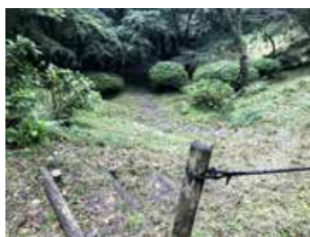
2015 擬木階段と進入禁止の木柵と ロープ。土の流出。階段の手摺は無い。
