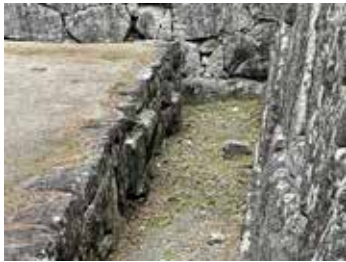
3025 石積水路の損傷、石垣間詰石 の崩落(南東から)
