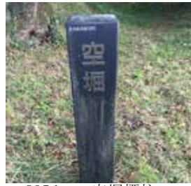
2056 空堀標柱 表面劣化。
