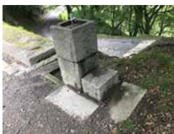
2002 水飲み場 大きな損傷はないが、 敷石が一部沈下
