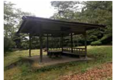
2021 四阿 設置面の土砂が流出している
