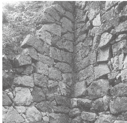
写真 41. 石垣 f 面隅角部
