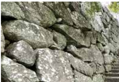
3056 第 1 駐車場～第 2 駐車場～三ノ丸東平場間の石垣の損傷
