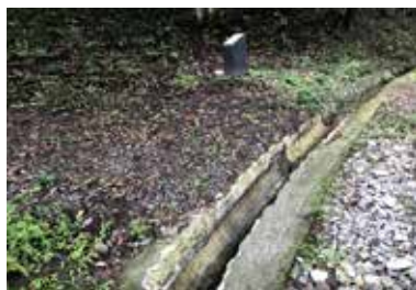
2037 護岸された二合田用水 擁壁の上面が欠損している。トンネ ル状だったか。
