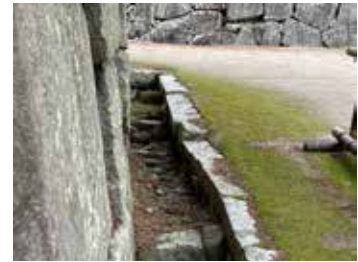
3024 石積水路の損傷 (南から)
