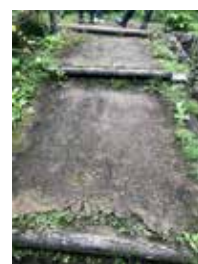
2009 舗装園路(スロープ状) 擬木接続部の剥離、舗装縁の欠損。
