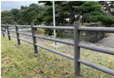
3053 擬木製の転落防止柵
