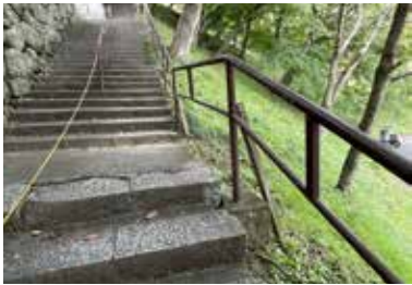
3052 第 1 駐車場～第 2 駐車場～三ノ丸東平場間の連絡階段と手すり 地震により一部損傷。
